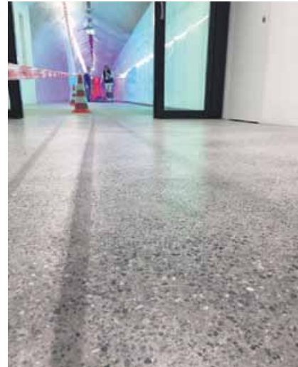
Der 120 Meter lange Verbindungsgang vom Parkhaus zur Altstadt stellte in der Praxis plötzlich ein echtes Risiko dar: er war ständig rutschig.
