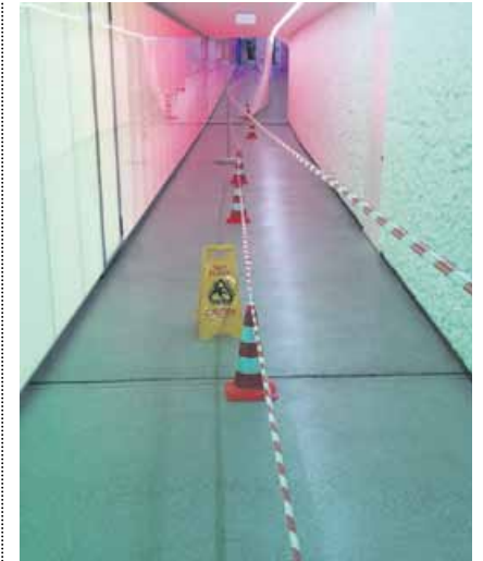
Wie lässt sich das geschliffene Terrazzo rutschfest und sicher machen? Abhilfe schafft nun eine transparente Oberflächenbeschichtung.
