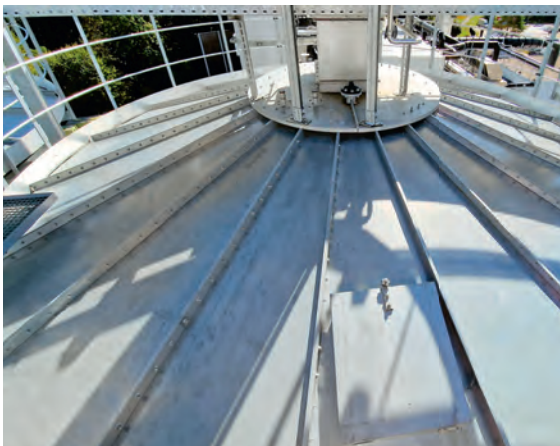
Die Silos haben einen Durchmesser von sechs Metern. Das Schrägdach aus Blech wurde vor allem im Winter rutschig. Die mittlerweile eingesetzte Oberflächenbeschichtung, mit der das Dach rutschfest gemacht wurde, ist laut Anbieter leicht in 30 Minuten aufzubringen. Nach zwölf Stunden war die Fläche wieder benutzungsbereit. Bilder: Grip Safety Coatings
