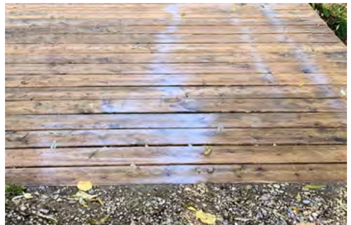
Wie Fussgängern und Radfahrern bei Regen, Feuchtigkeit und überfrierender Nässe eine sichere Überquerung über die Holzbohlen bieten?
