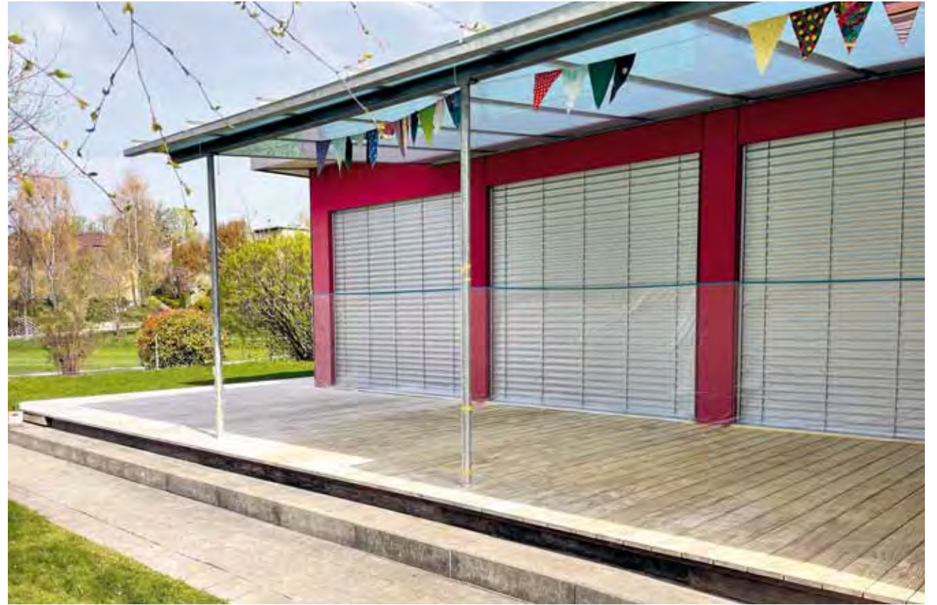
Ohne Beschichtung entpuppte sich das eingesetzte modifizierte Holzprodukt bei Regen, Nässe und Kälte als gefährliche Rutschbahn – mit Beschichtung ist alles einwandfrei. Fotos: Grip Safety Coatings
