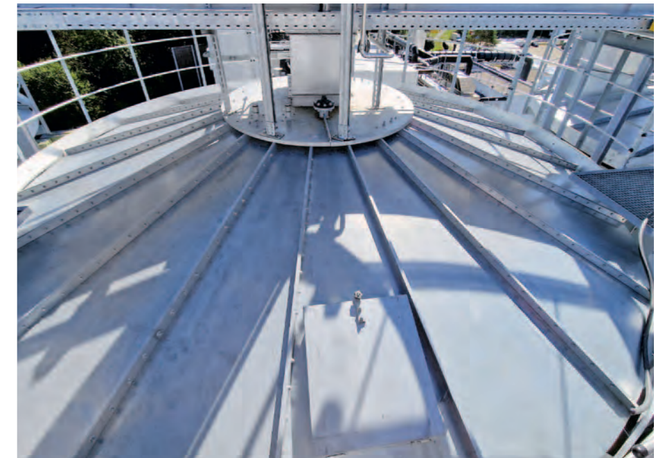
▲ Inzwischen sicher zu betreten: Eines der drei jeweils 53 m 2 großen Silodächer aus Blech, die nach einer Reklamation des Bauherren mit einer Antirutsch-Beschichtung versehen wurden
