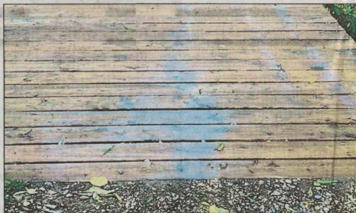
Nasse Holzplanken erhöhen die Rutschgefahr.
