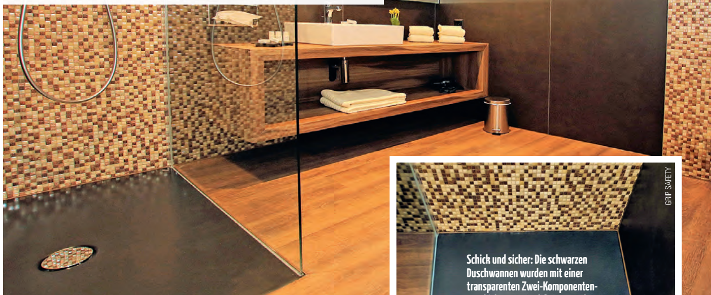
Im Sanitärbereich des Hotel von Rotz kam die Beschichtung Grip AntiRutsch in den Stahl-Emaile-Duschwannen zum Einsatz.
