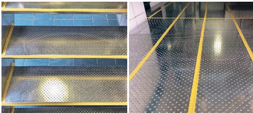
Die mehrstufige Edelstahlterasse besitzt einer Oberfläche mit Noppen, trotzdem entwickelte sich bei Nässe eine hohe Rutschgefahr. Mit der Antirutsch-Beschichtung konnte die Gefahrenstelle beseitigt werden.
