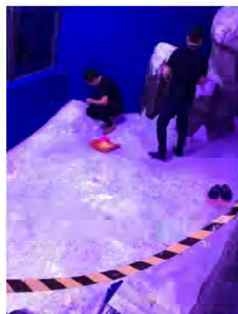
Grip Anti-Rutsch wurde auf einer Fläche von insgesamt 60 m 2 aufgebracht. Dank der einfachen Anwendung kein Problem für das Team von Partner Myako. Foto: Grip Safety Coatings
